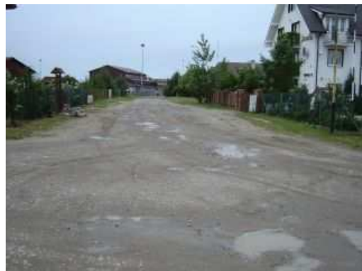
ul. Słowackiego – aktualny stan techniczny
